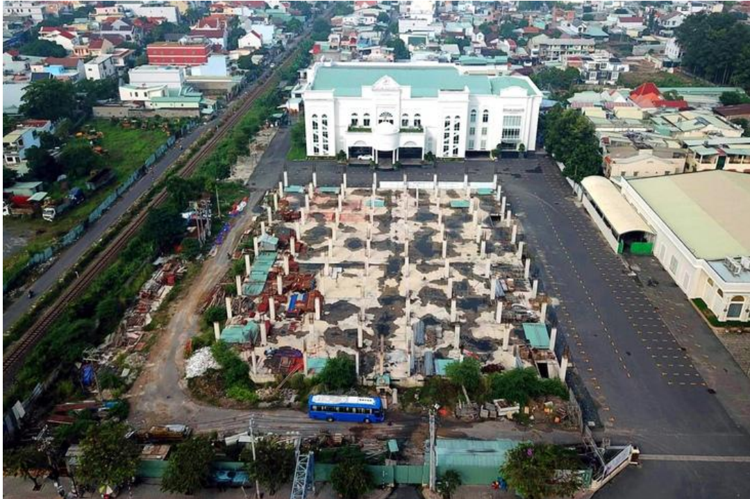
Hình 3. 1: Dự án Eros Palace (P. Tân Tiến, Biên Hòa, Đồng Nai) XD khu căn hộ cao cấp và dịch vụ trên diện tích hơn 2,2 ha hoàn toàn không có GPXD
